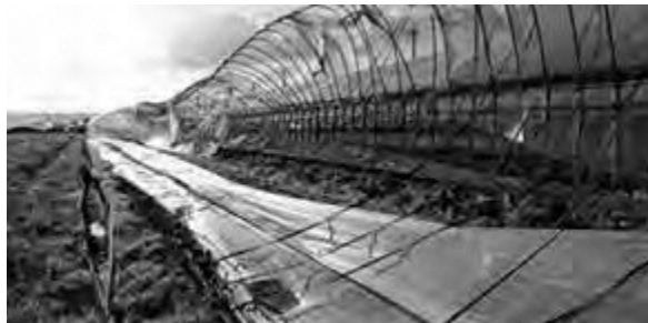
台風24号によって被災した農業用施設
