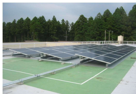
太陽光発電パネル（役場本庁舎）
